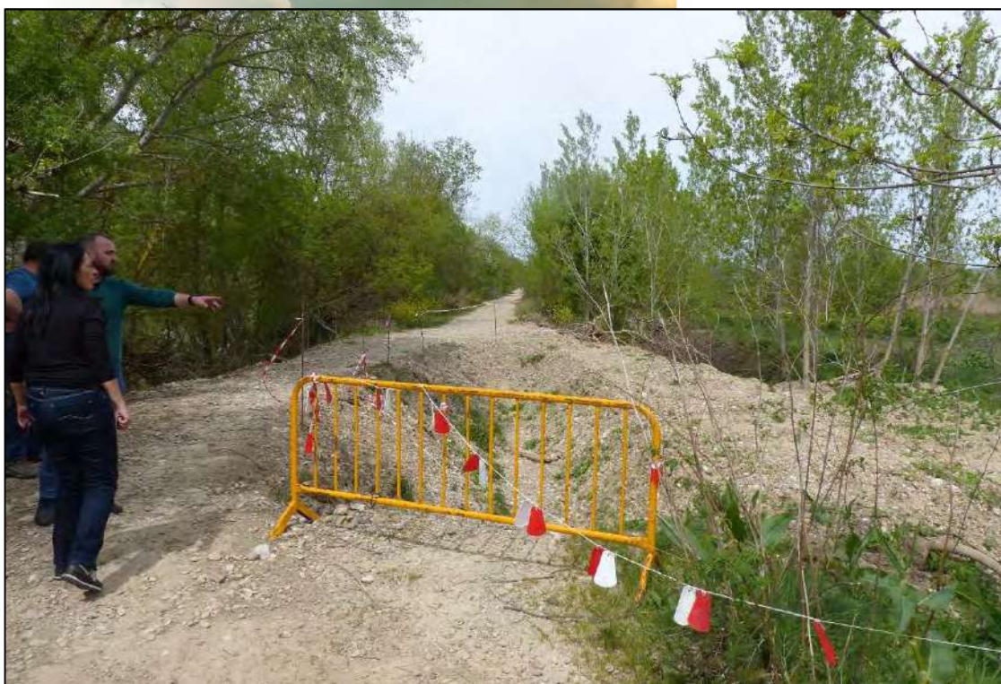
*Fotografía tomada en abril de 2022 de las reparaciones llevadas a cabo en la mota de Falces, aguas abajo del casco urbano de la localidad.
